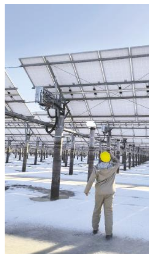
渔光物联运维人员冬季巡检
