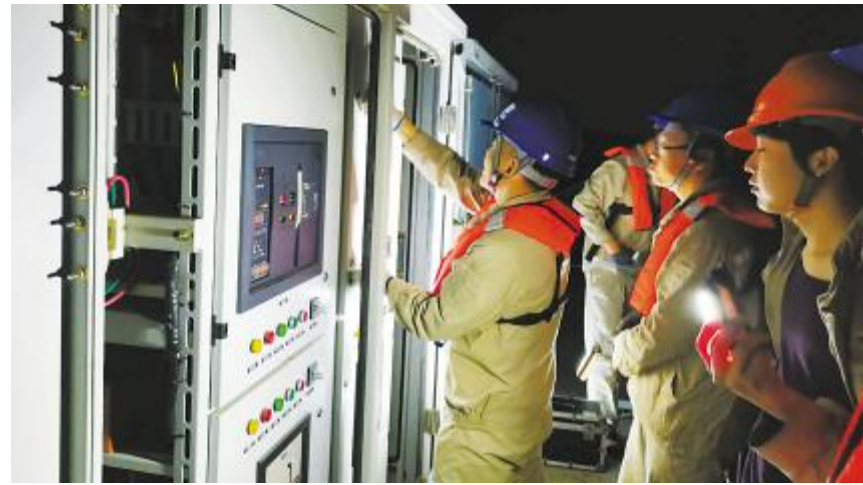
夜间年检预试,确保发电零损失
