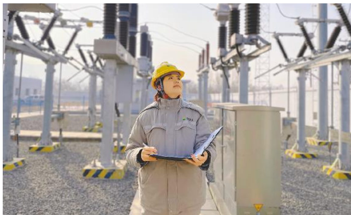
运维工作人员查看设备运行情况
