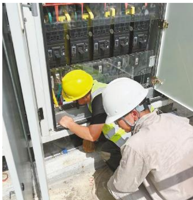
通威宾阳“渔光一体”基地运维人员巡检设备
