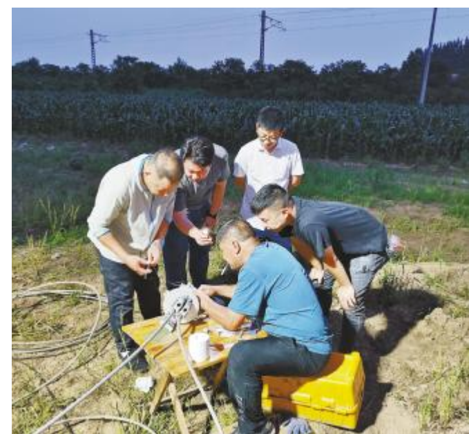
项目工作人员连夜帮助电网公司线路熔纤,完成时已凌晨四点
