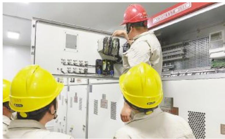
通威肇源“渔光一体”基地运维人员排查设备隐患
