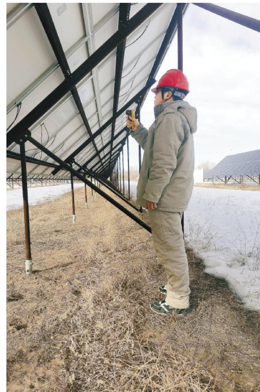
赤峰电站巡检设备不停工
