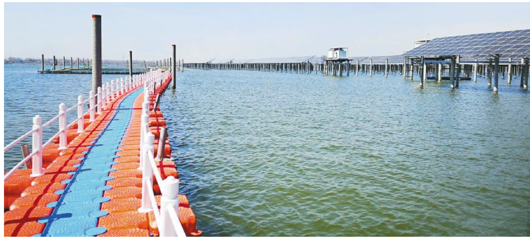
通威泗洪“渔光一体”基地
