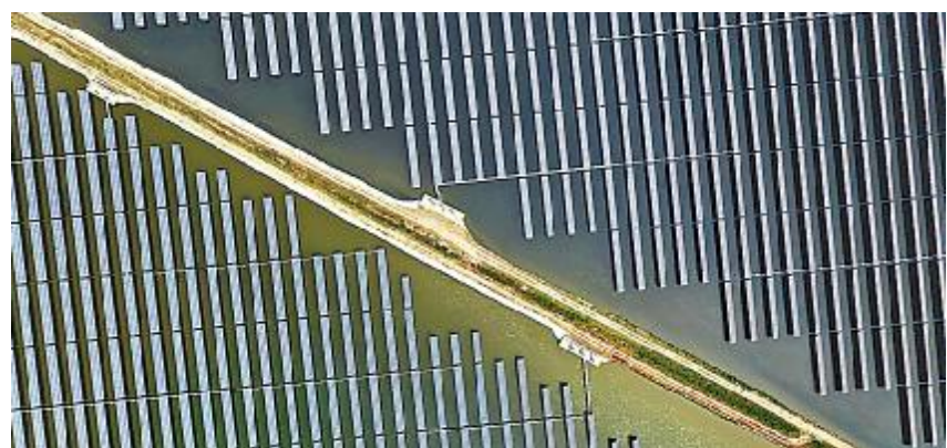
通威河北唐山“渔光一体”项目
