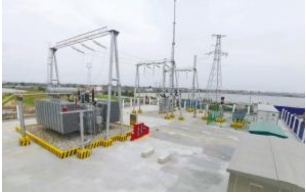
常德项目升压站
